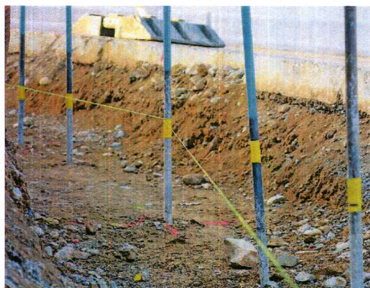
Das Gefälle an der Kreuzung Strengelbacherstrasse-Frikartstrasse ist zu steil und muss angepasst werden. Die gelbe Schnur zeigt, auf welcher Höhe die Strasse eigentlich verlaufen sollte und künftig wohl auch wird. ...
